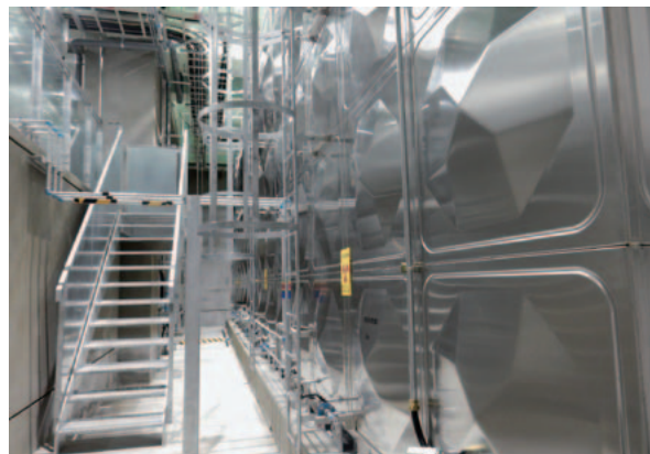
写真 3 80m 3 の貯留槽および希釈槽
