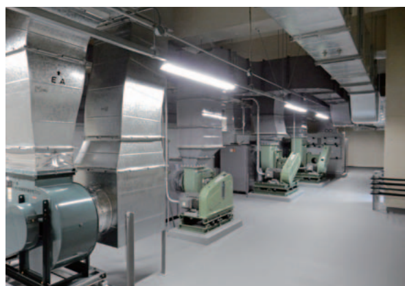
写真 7 4階屋内の排気設備室
