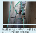
集合箇所まで全てが集合した排水管をカットして内部を汚染検査
