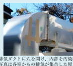
排気ダクトに穴を開け、内部を汚染検査写真は各室からの排気が集まった屋上の排気フィルター前の排気ダクト
