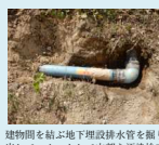
建物間を結ぶ地下埋設排水管を掘り出して、カットして内部を汚染検査
