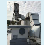
屋上の配管の入り口部と屋上排気設備
