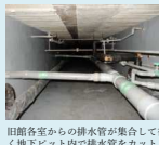
旧館各室からの排水管が集合して行く地下ビット内で排水管をカットし、各室の排水管を汚染検査
